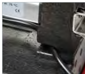
Kabelführung cable channel
